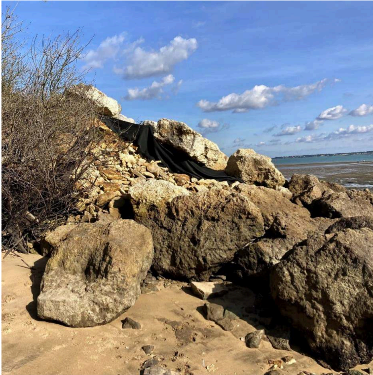
Figure 16. L'érosion abîme l'extrémité de l'enrochement réalisé pour conforter l'assise de la voie du petit train
